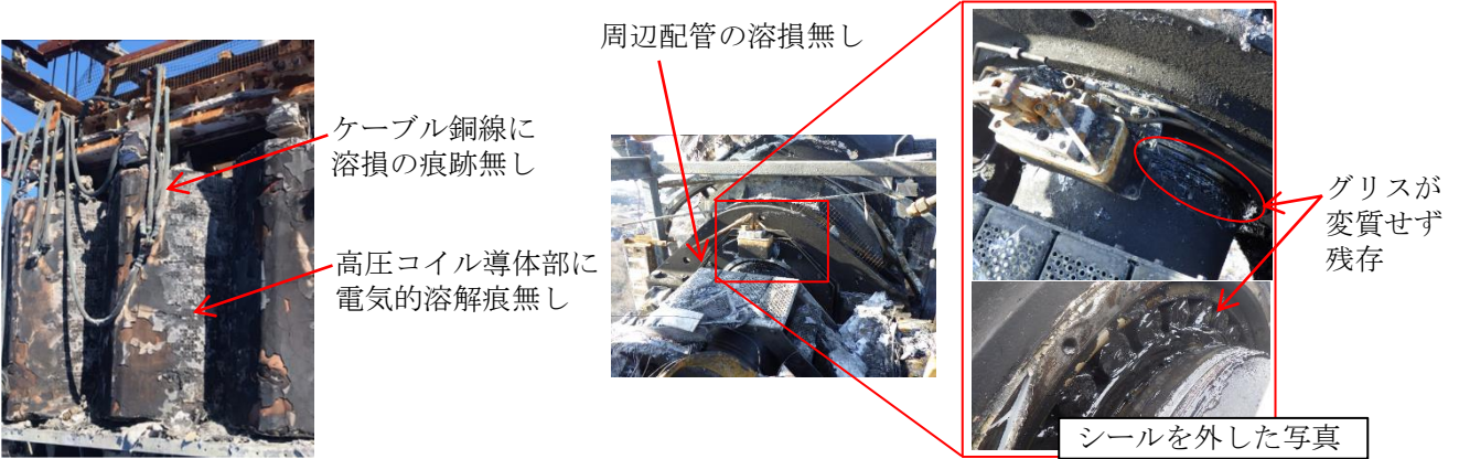
図-3 火災後の変圧器
