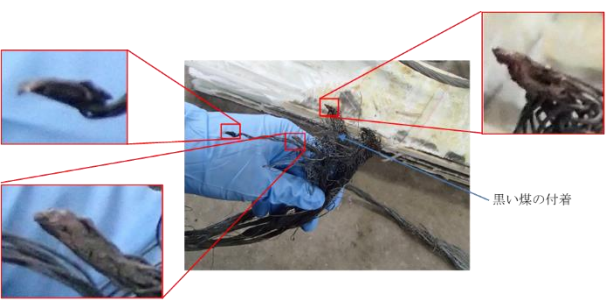
図-5 ダウンコンダクター溶断部
