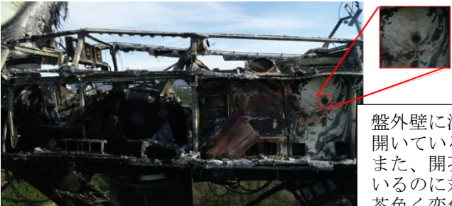
制御盤の焼損状況
